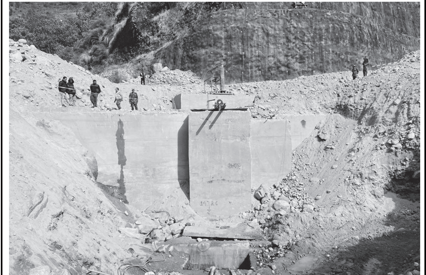
हेलम्बु गाउँपालिका वडा नम्बर १ अम्बाथानस्थित बाढीले क्षति गरेको मेलम्ची खानेपानीको निर्माणाधीन नौ नम्बर गेट । सरकारले माघ पहिलो साता यहाँको पानी काठमाडौँ पुऱ्याउने लक्ष्य लिएको छ । तस्विर:देवराज सुवेदी/रासस
