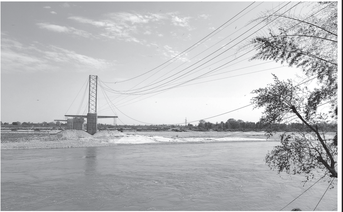
निर्माणाधीन भोलुङ्गे पुल कैलालीको टीकापुर दौलतपुर हुँदै बर्दिया राजापुर नगरपालिकासँग जोड्न कर्णाली नदी माथि निर्माण भइरहेको भोलुङ्गे पुल । तस्विर: फलनाथ खनाल/रासस
