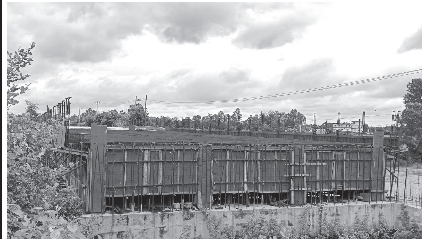
अलपत्र अवस्थामा रहेको ढल्केबरस्थित बसही खोलाको निर्माणाधीन पुल धनुषाको ढल्केबर-जटही सडकखण्डअन्तर्गत धनुषाको ढल्केबरस्थित बसही खोलामा निर्माणाधीन पुल । उक्त सडकखण्डमा ६ लेनको सडक निर्माण कार्य सम्पन्न भइसके पनि वर्षौंदेखि पुल निर्माण कार्य अलपत्र पर्दा स्थानीयवासी एवं यात्रुले सास्ती भोग्न बाध्य छन् । विसं २०७६ असार ३१ गते नागार्जुन हेम कन्स्ट्रक्सन जेभीले ठेक्का सम्झौता गरेर बसही खोलामा पुल निर्माण सुरु गरेको थियो । तस्विर स् राजु विश्वकर्मा/रासस
