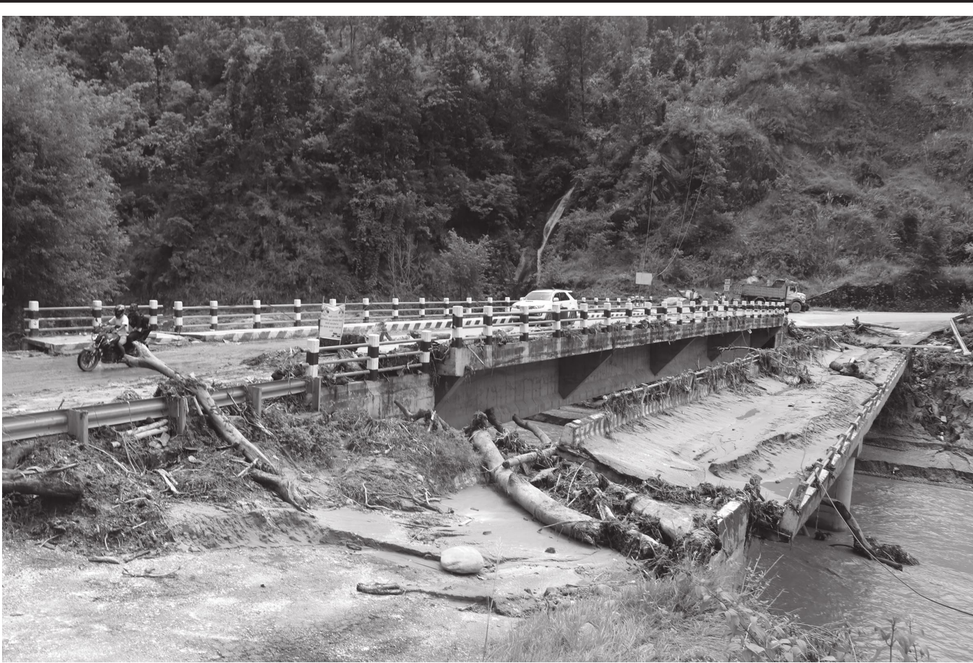
क्षति पुगेको कोल्पुखोला पुल भोटेकोसी हुँदै त्रिशुली नदीमा आएको बाढीको बहाबले नुवाकोट र धादिङ जोड्ने कोल्पुटारस्थित कोल्पु खोलाको एकै स्थानका दुईवटा पुलमा क्षति । दुईमध्ये एउटा पुल पूर्ण क्षति र अर्को कोल्टिएको भए पनि वैकल्पिक मार्ग नहुँदा यातायातका साधन जोखिमयुक्त पुलबाट आउजाउ गर्न बाध्य छन् । तस्विर: रामहरि न्यौपाने/रासस
