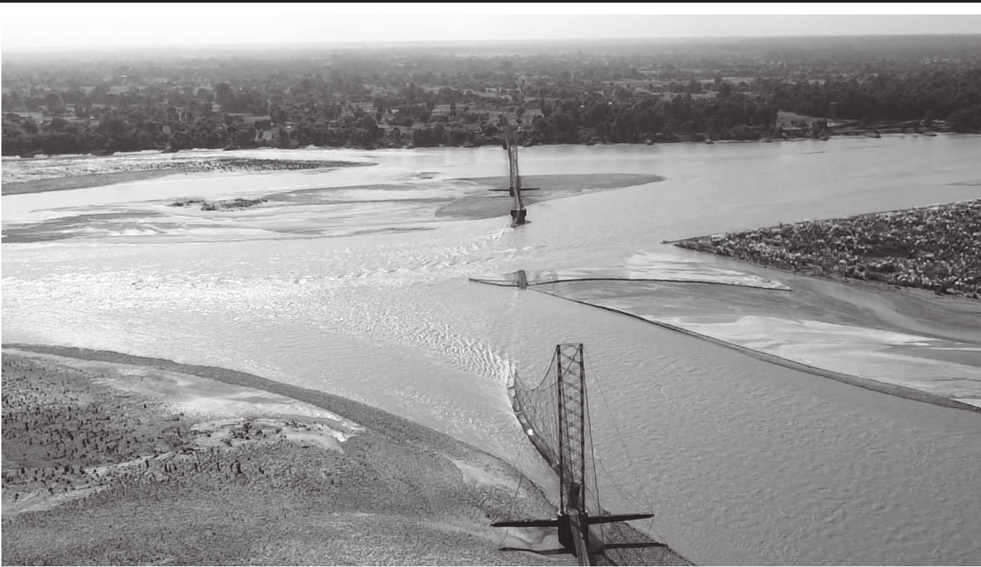
दोधारा चाँदनी भोलुङ्गे पुलको पिलर भत्कियो कञ्चनपुरको महाकाली नदीमा अवस्थित दोधारा चाँदनी भोलुङ्गे पुलको भत्किएको एउटा पिलर । भीमदत्त नगरपालिका र दोधारा चाँदनी नगरपालिका जोड्ने पुलको एउटा पिलर भत्किनुका साथै पुलको करिब ६ मिटर भागसमेत मर्मत गर्नुपर्ने भएपछि आवागमन रोकिएको छ । तस्बिर: शेरबहादुर सिंह/रासस
