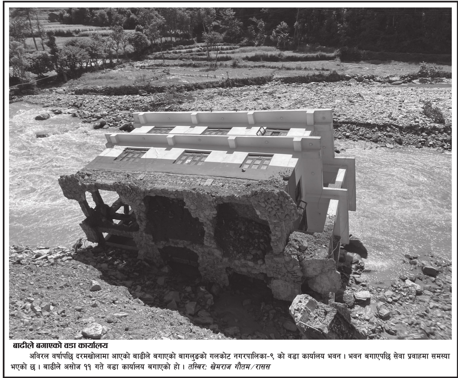
बाढीले बगाएको वडा कार्यालय अविरल वर्षापछि दरमखोलामा आएको बाढीले बगाएको बागलुङको गलकोट नगरपालिका-९ को वडा कार्यालय भवन । भवन बगाएपछि सेवा प्रवाहमा समस्या भएको छ । बाढीले असोज ११ गते वडा कार्यालय बगाएको हो । तस्विर: खेमराज गौतम/रासस
